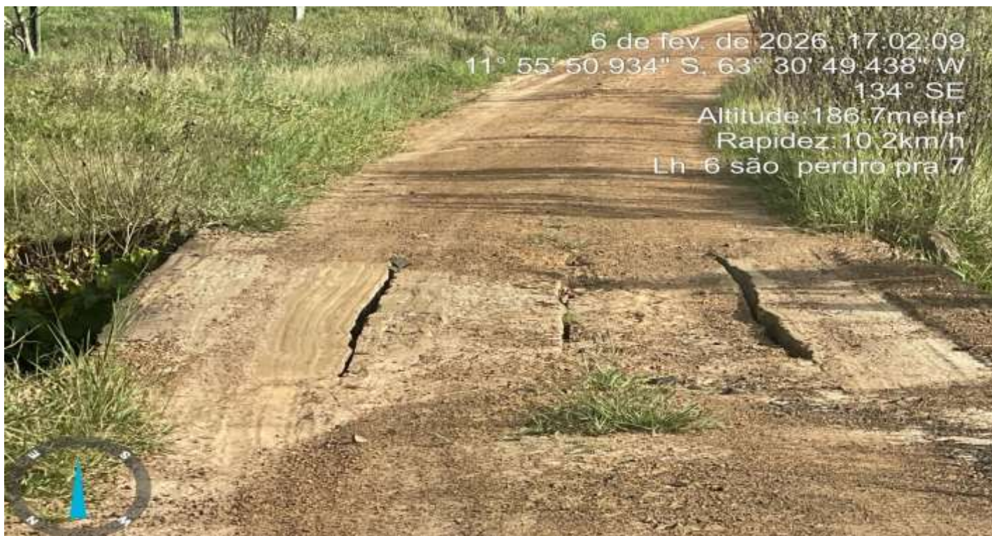
LINHA 07 São Pedro (03 tubos de 1200mm)
